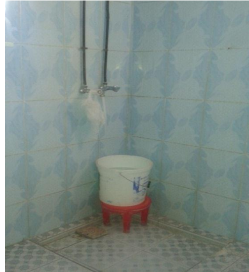
Photo N° 8 stockage de l'eau dans le SDB
