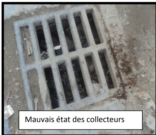
Figure N°44 : Mauvais état des collecteurs
