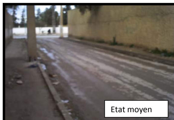
Figure N°40 : Etat de la voie
