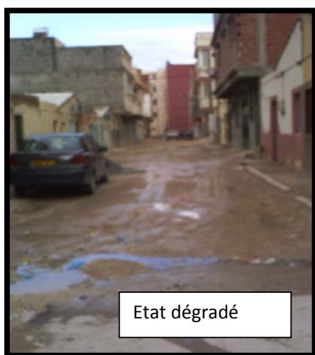
Figure N°41 : Etat de la voie
