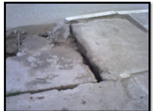
Figure N°45: Mauvais état des collecteurs
