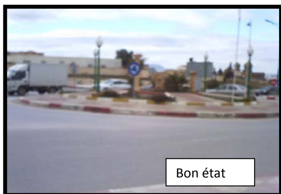
Figure N°39 : Etat de la voie
