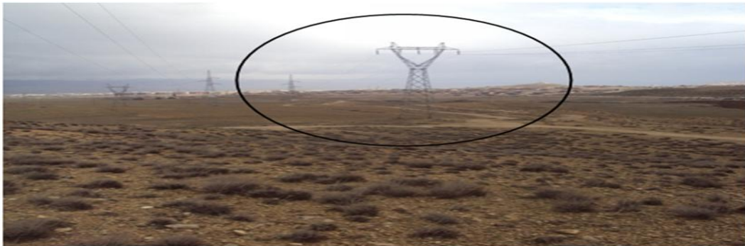
Photo 10 : ligne de transport de l'énergie électrique de haute tension
