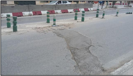
Photo 50: chaussée dégradée sur l'artère Rn n° 10. Source : Auteur, Mai 2016
