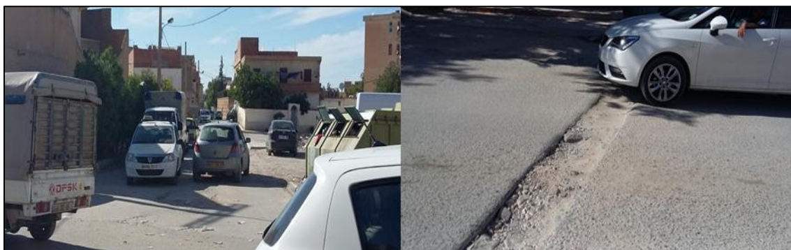
Photo 30: Chaussée dégradée des voies secondaires
