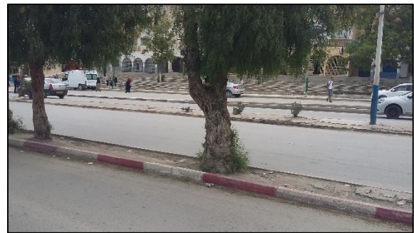
Photo 43: Terre-plein dégradé et mal conçu Source : Auteur, Mai 2016
