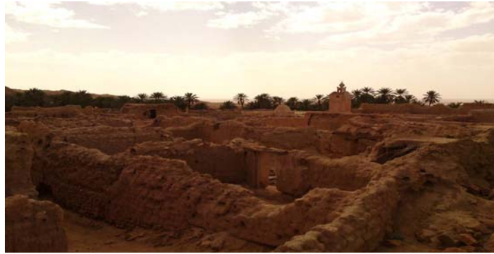
Photo 42 : flambement des murs
