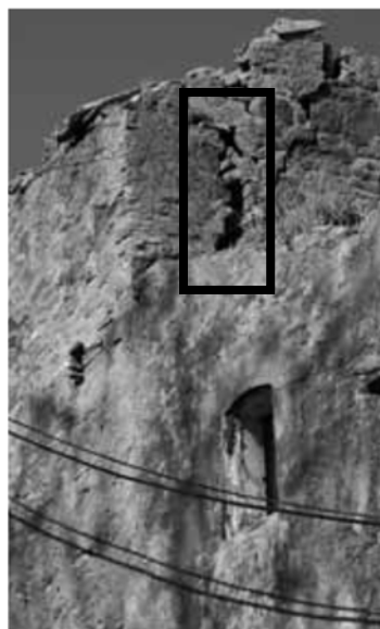
Photo33 : l'affaissement des fondations (mur)
