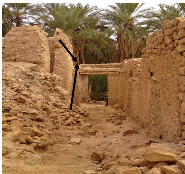
Photo 39 : action du vent sur le mur
