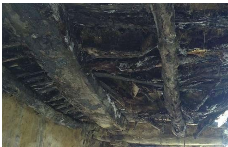
Photo38 : Dégradation des planchers
