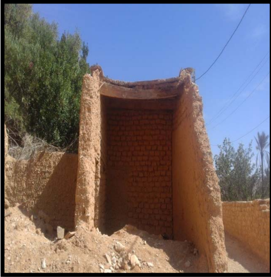
الصورة رقم (46): توضح الحالة المزرية التي آلت اليها البيوت المهجورة.
