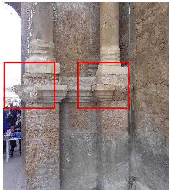
Photo 08 : Dégradation au niveau du piédestal, source : l'auteur.
