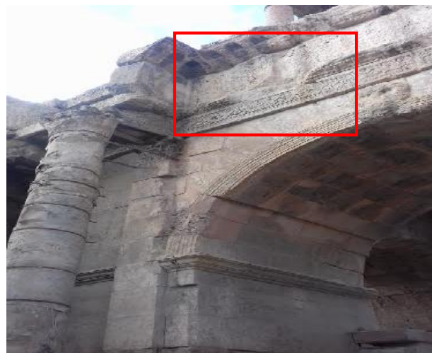
Photo 14 : Dégradation des ornements, source : l'auteur.
