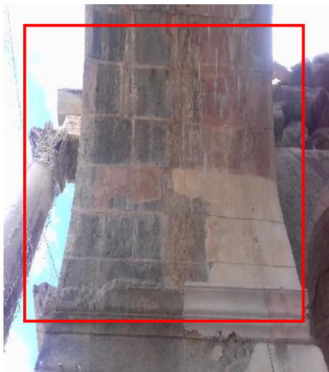
Photo 17 : Ecaillage des revêtements et Les taches humides, source : l'auteur.
