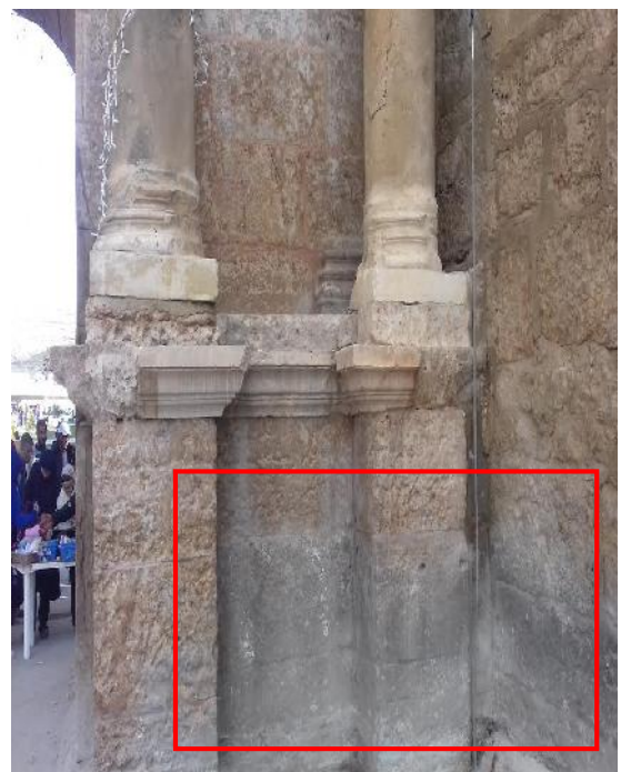
Photo 10 : Taches de ciment au niveau du piédestal, source : l'auteur
