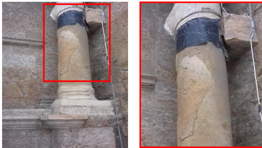
Photo 05 : Dégradation au niveau de la colonne, source : l'auteur
