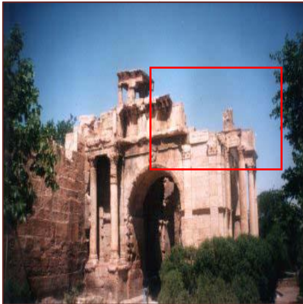
Photo 11 : Dégradation au niveau supérieur de la porte de Caracalla, source : l'auteur.
