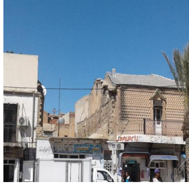
الصورة رقم 30: الحالة المزرية التي آلت اليها البنايات(سقف مهترئ ، تشققات)
