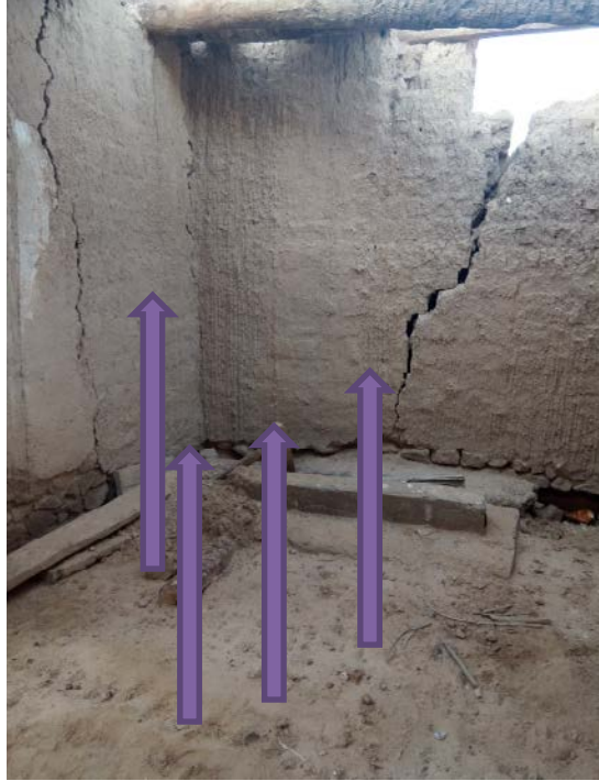
صورة رقم 28: poussée des murs
