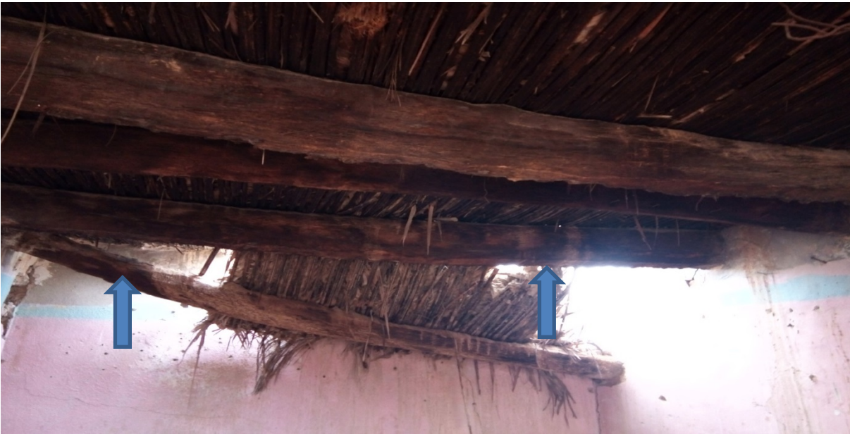
صورة رقم-55-:سقوط السقف بسبب استخدام روافد نخيل غير ملائمة
