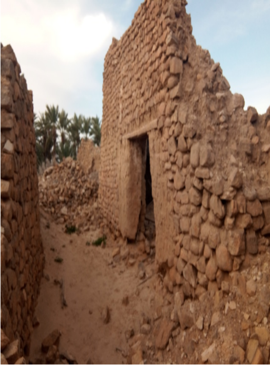
صورة رقم 29: effondrement des murs
