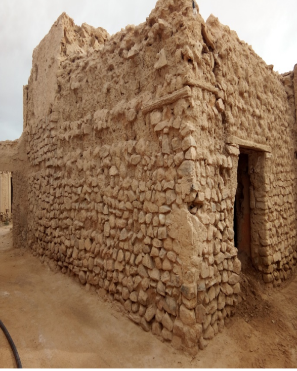
صورة رقم 33: décollement d'enduit
