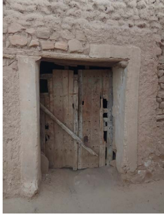
صورة رقم 32: .érosion des murs
