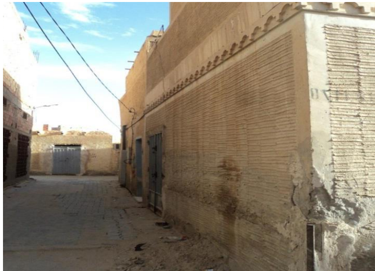
(fig36) détérioration des façades et du pavé source : photo prise par l'auteur- mai2019
