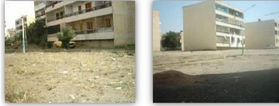
الصورة رقم 3 : حالة الفضاءات الخارجية الصورة رقم 4 : حالة المساحات الخضراء المصدر : فاتح بوقاعة - التحسين الحضري حالة حي 600 بمدينة سطيف - جامعة ام البواقي 2008
