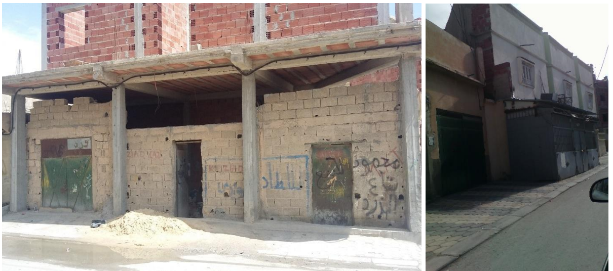
Figure 53 : Des habitations hors normes de construction. Source : Auteur, 2020.
