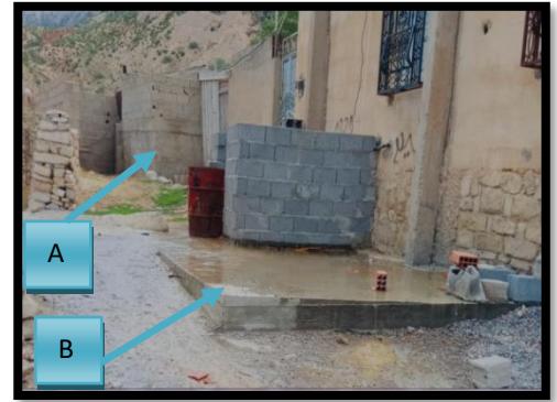
Photo 57. (A) bâche à eau semi enterrée (B) Bâche à eau enterrée. Source: auteur
