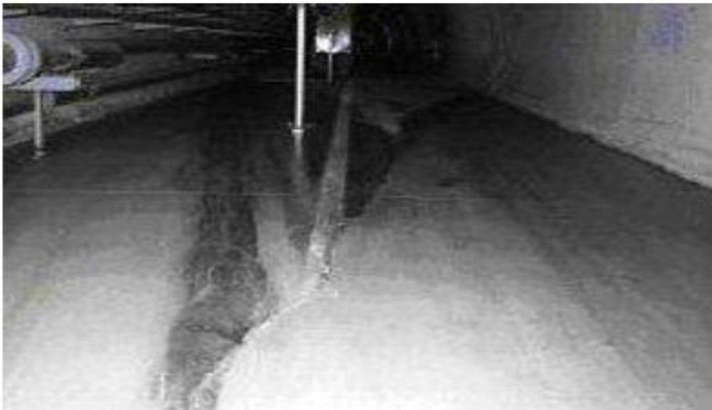
Figure2.33 Soulèvement puis dislocation du radier d’un tunnel.
