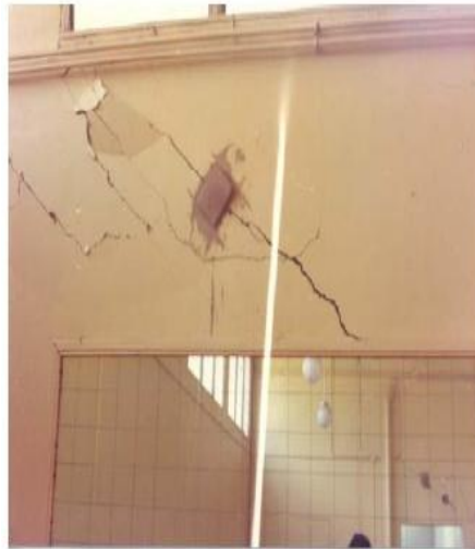
Figure 2.32 dégradation dues au Gonflement (hôpital Moulay Ismail, (Meknès))
