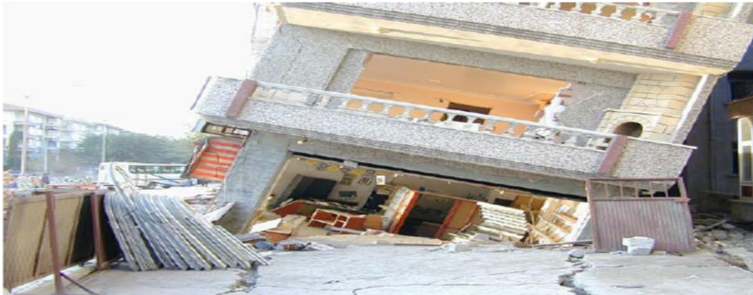
Figure 1.7 Poinçonnement du sol de fondation [25]
