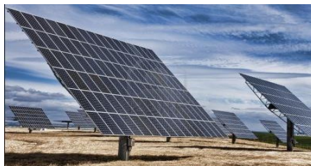
Figure I.4. Les panneaux photovoltaïques [2].
