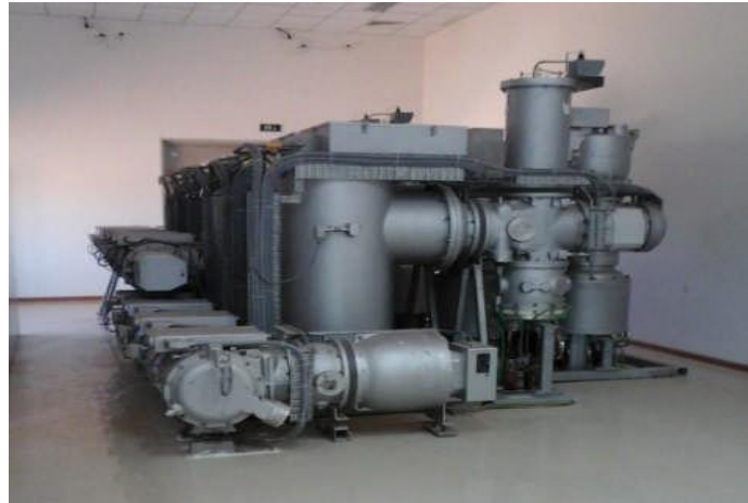
Fig I.8 le poste GIS au niveau du champ de Zarzaitine.
