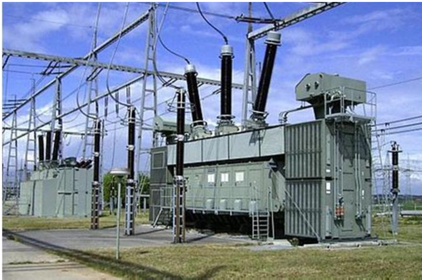
Figure I.3 Un transformateur de puissance dans un poste électrique.
