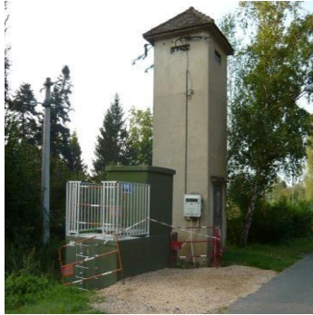
Figure I.2 Poste de distribution cabiné
