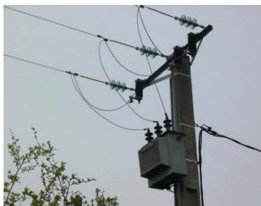
Figure I.1 Poste de distribution sur support
