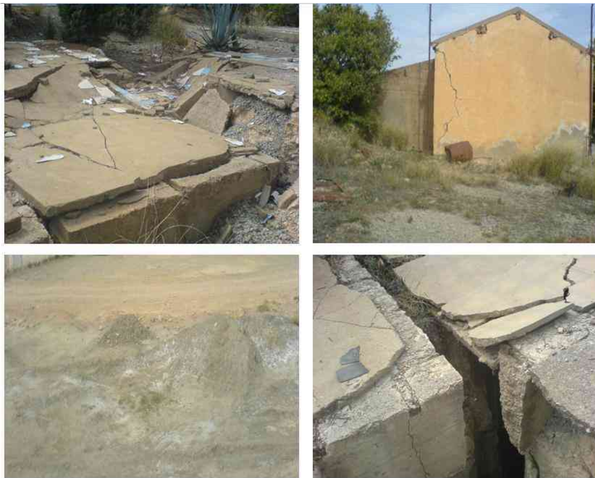
Fig. 8 Fractures et de fissures au-dessus des anciens travaux miniers, Mine Kherzet Youssef-Sétif (Boukelloul, 2007).
