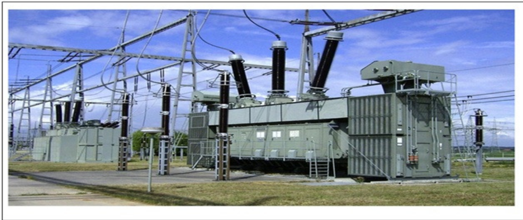
Figure 1.3: transformateur de puissance
