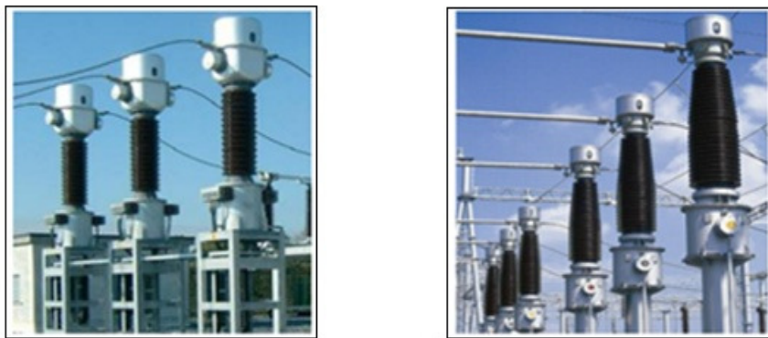
Figure 1.4: Les transformateurs de mesure.
