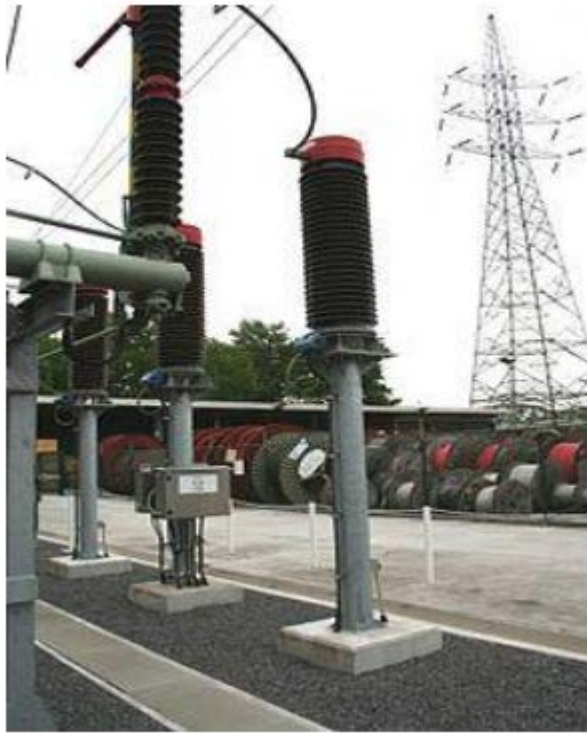
Figure 2.7 Transformateur de tension nominale 150 kV.
