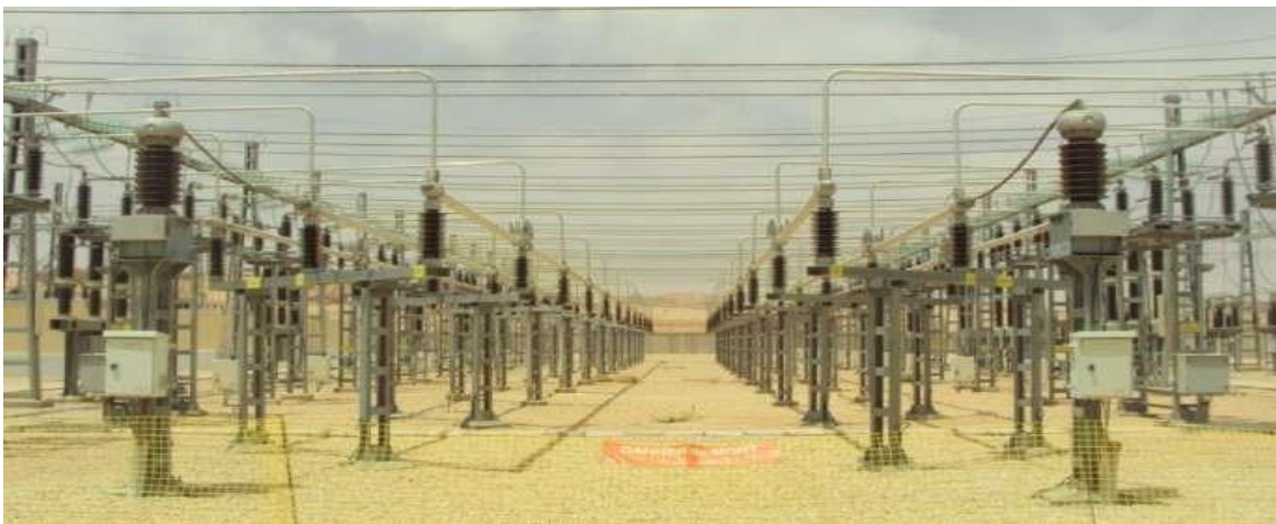
Figure.1.5. Poste électrique haute tension.
