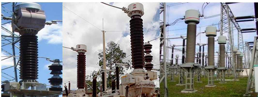
Figure 3.13 Transformateur de tension
