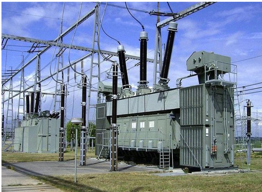
Figure 3.10 les transformateurs de puissance
