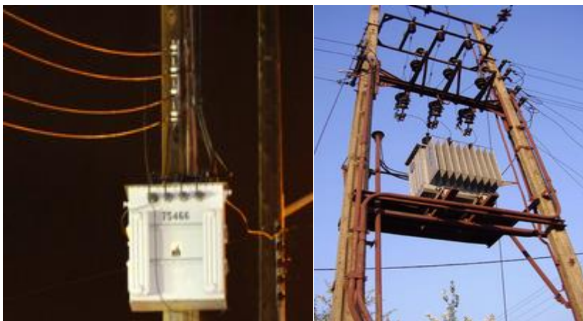
Figure 3.2 Transformateurs triphasés HT/MT suspendus a des supports électriques
