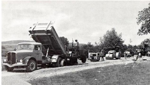
Figure31 : Construction d'un chemin avec matériaux stabilisé selon le procédé mix in plant.
