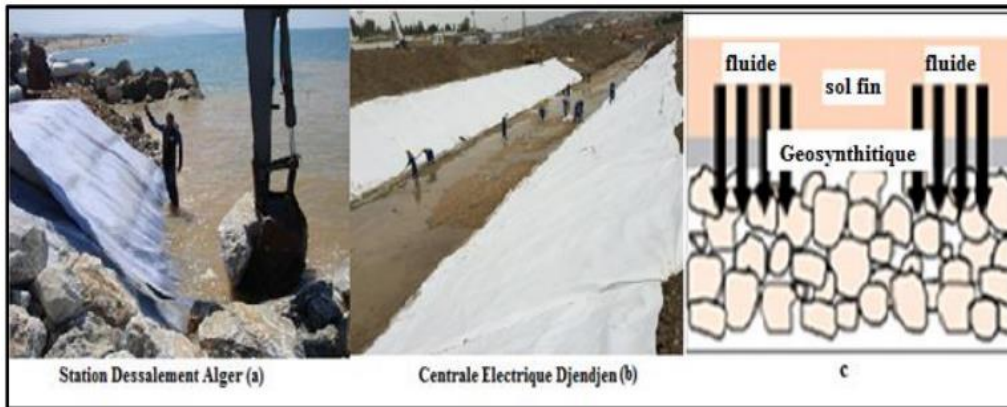
Figure 3.15 Le filtrage de terrain par les produits géosynthétiques a et b [15] et c [2].
