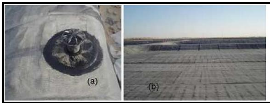
Figure 2.19 (a) Event de dégazage et (b) vue des bassins avec Géomembrane posée.
