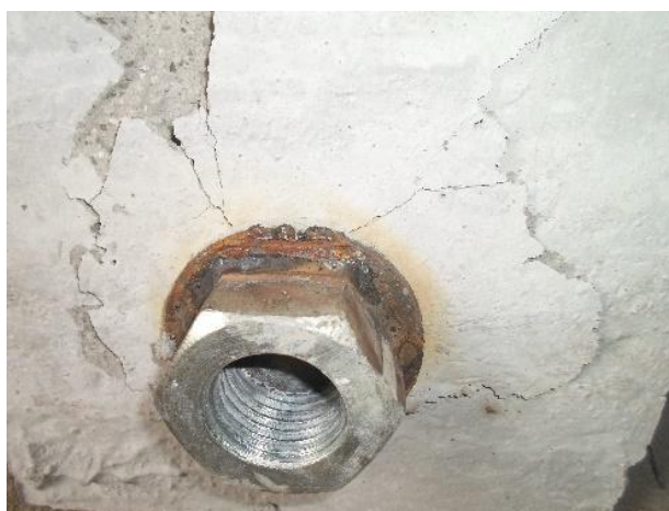
Figure 3. 11 Fissuration et éclatement du béton
