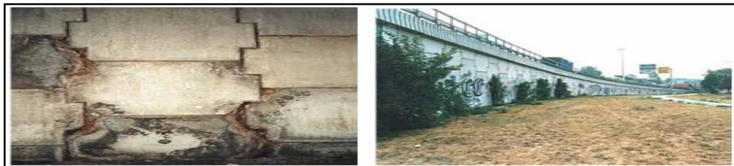
Figure 3.37. Dégradation du béton d'une écaille par réaction sulfurique externe et défaut d'entretien
