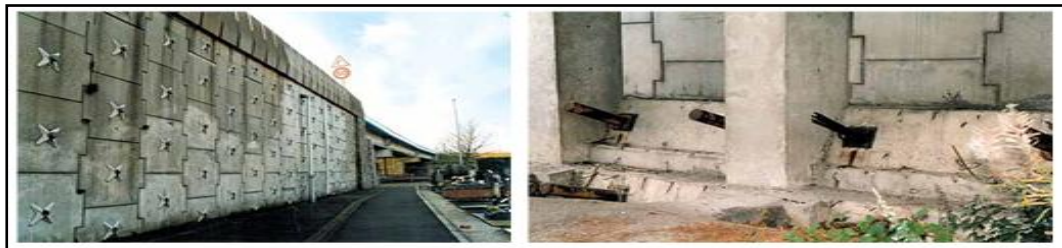
Figure 3.39. Renforcement par clouage des écailles, ou par des tirants au pied du mur
