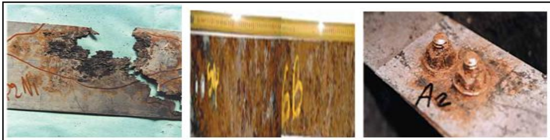
Figure 3.34. Corrosion des renforcements métalliques
