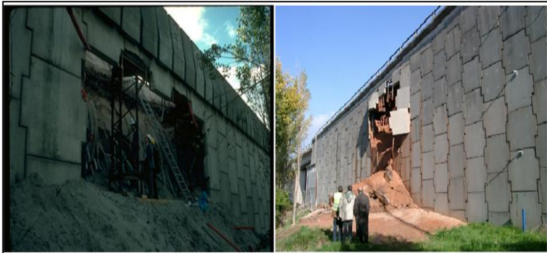
Figure 4.1. Rupture d'un massif renforcé
