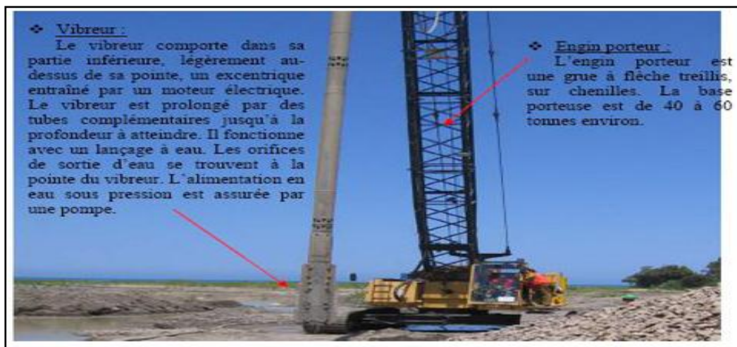
Figure 2.5. Moyen de mise en œuvre pour les colonnes ballastées à voie humide
