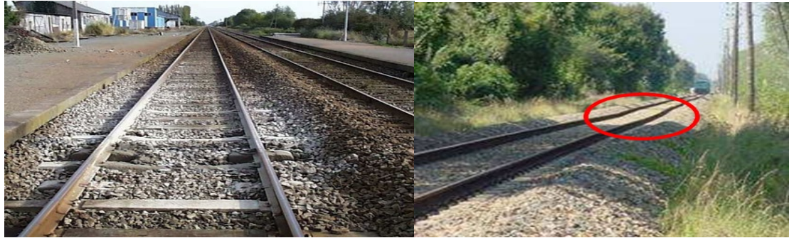
Figure (I.15.a): Photo d'une zone de remontée boueuse . Figure (I.15.b): Photo d'une zone de défaut de portance[11]
