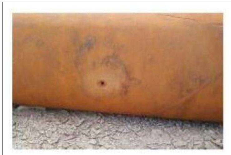
FIGURE 2.17 – Corrosion par piqûre [19]
