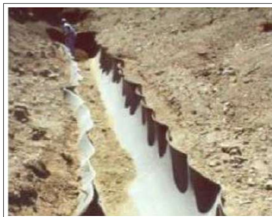
FIGURE 2.9 – Éclatement d'un pipeline [19]
