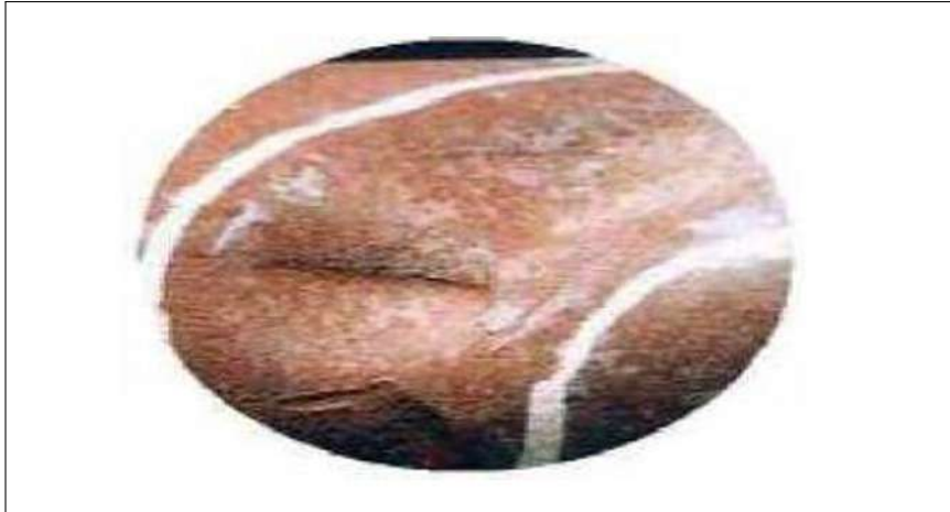
FIGURE 2.14 – Photo d’une écaillage dans un enfoncement [19]
