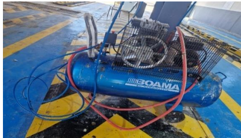
Figure 62: Compresseur d'air utilise pour l'alimentation en air comprime de la station
