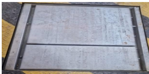
Figure 49: Plaque de ripage encastrée pour la mesure de la dérive
