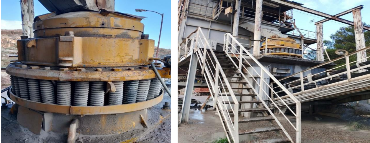
Figure I.9 : Vue de la section de concassage et criblage de l'usine de Kherzet Youcef
