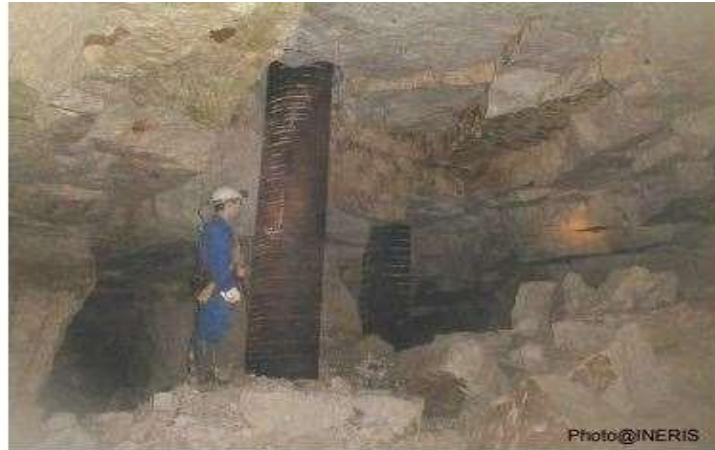
Figure 1.19 Pieu traversant une cavité.
