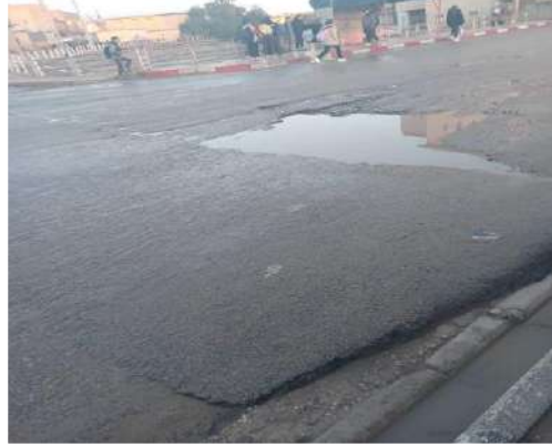
الصورة رقم 46: تشققات وحفر بالطرقات
